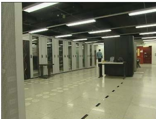
Abbildung 27: Schlussequenz im Serverraum
